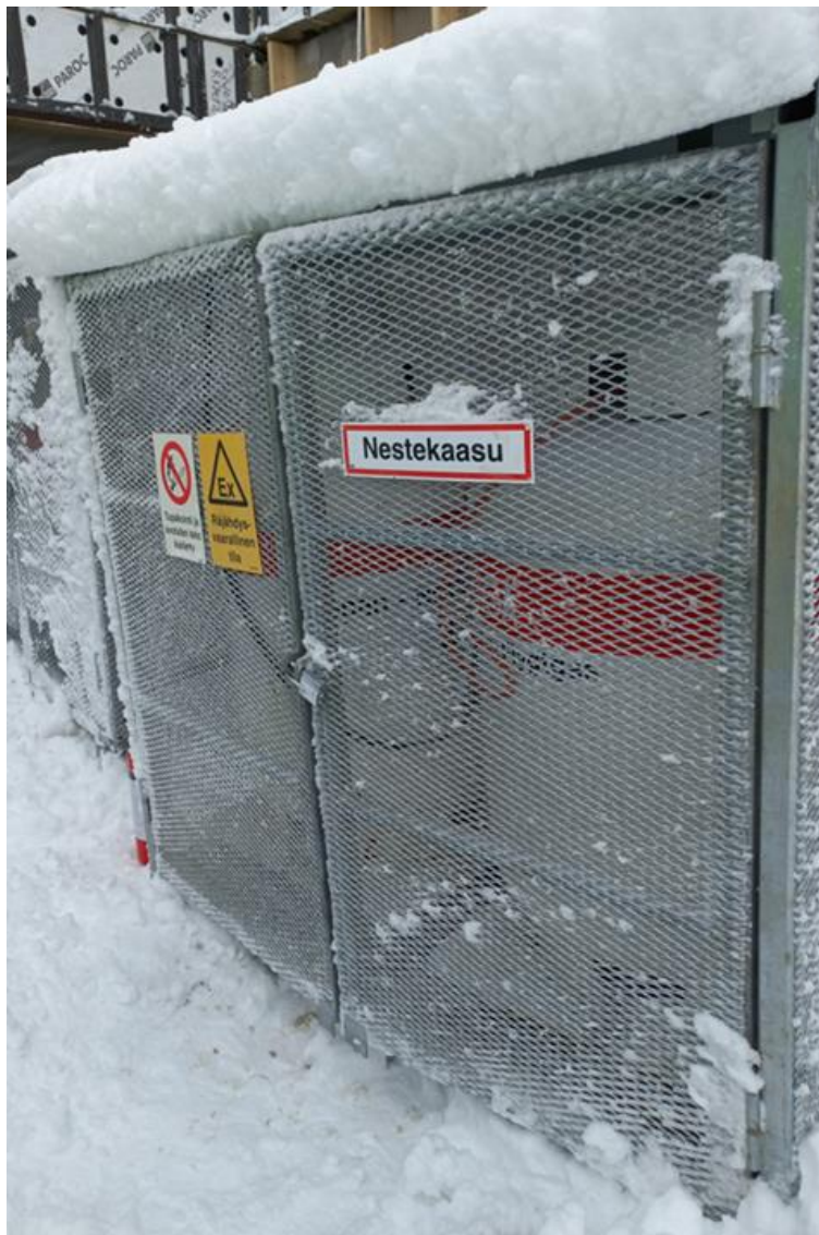
Bild 1. Exempel på en lösning där låsanordningen, väderskyddet, ventilationen, vinterunderhållet framför skåpet och varningsmärkningarna är som de ska. Källa: Västra Nylands räddningsverk.
