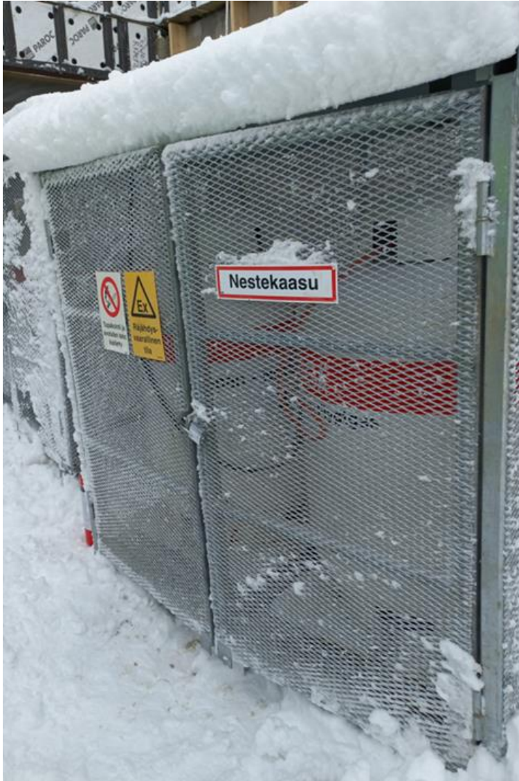
Kuva 1. Esimerkki ratkaisusta, jossa lukitus, sääsuojaus, tuulettuvuus, talvikunnossapito kaapin edessä ja varoitusmerkinnät kunnossa. Lähde: Länsi-Uudenmaan pelastuslaitos.
