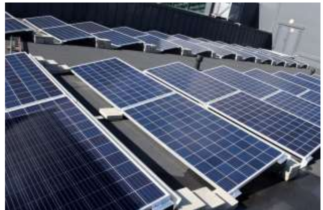
Solpaneler på taket till ett köpcentrum. (Foto: Yle)
