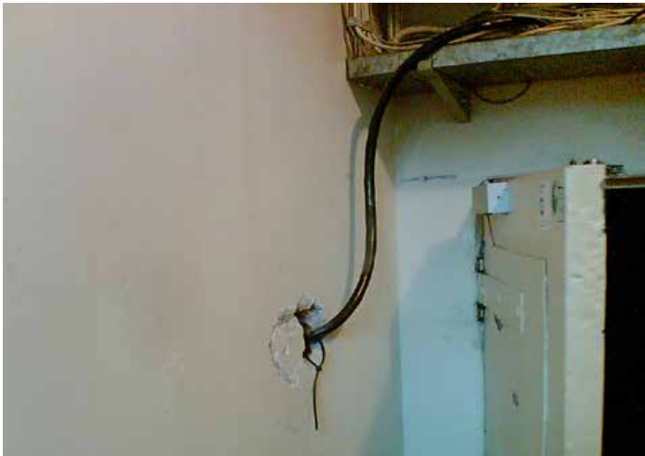
Kuva 12. Läpiviennin tiiveys on puutteellinen osastoivassa seinässä.
