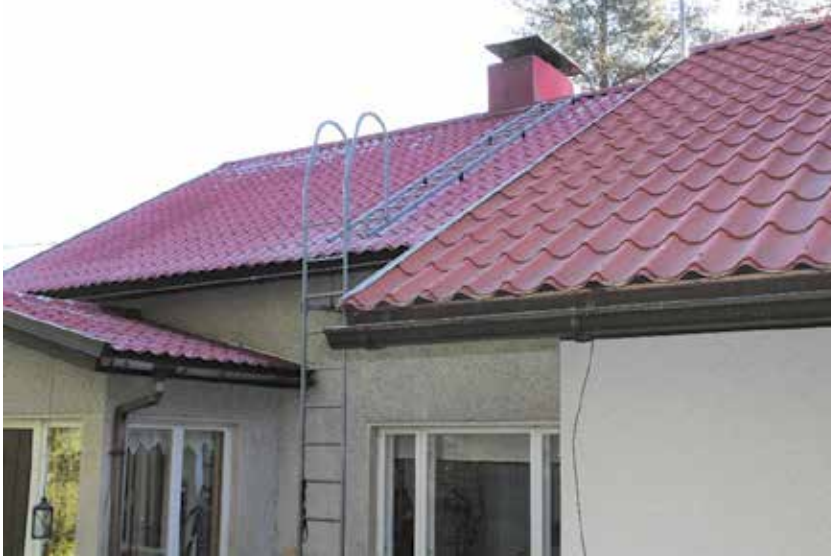
Kuva 16. Nuohoojalla tulee olla käytössä turvallinen kulku piipulle.
